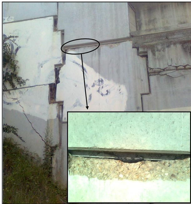
Figure 1. Muro de tierra reforzada, con patologías de desconchamiento debido a desplazamientos relativos excesivos entre paneles del paramento.
