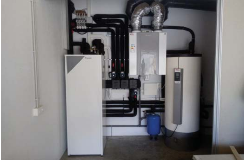
Maquinària d'aerotèrmia Daikin en habitatge passiu de House Habitat (Sant Cugat del Vallès) i col·locació del terra radiant (foto inferior)
