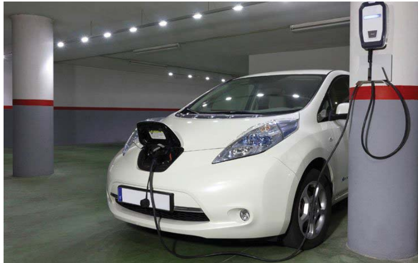
Punt de recàrrega de vehicle elèctric
