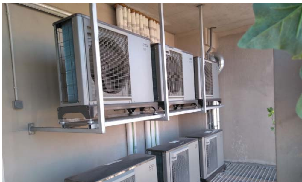
Sistema de producció íntegra en aerotèrmia, de calefacció, refrigeració i ACS
