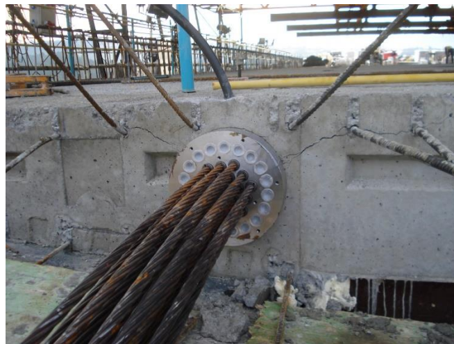
Fig.4.5.1. Fisuración del hormigón a causa de las fuertes tensiones en la zona de anclaje.
