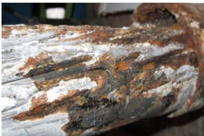
Fig. 4.3.35.2..Corrosión de un tendón postesado debido a la deficiencia de lechada de cemento
