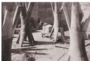
Pilars acabats de desencofrar Fotografia del Sr. Calixto, operari a la construcció de Susqueda. Diari de Girona 29 de novembre de 2009
