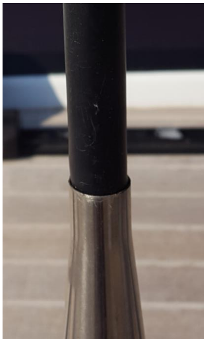
Ilustración 110. Unión terminal con jarcia de carbono compacto. Fuente: Propia
