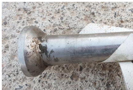
Ilustración 98. Cabezal prensado de varilla fisurado. Fuente: Propia
