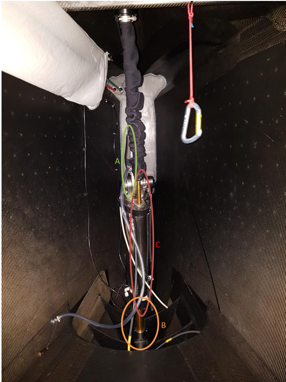
Ilustración 42. Tensor hidráulico de estay. Fuente: Propia
