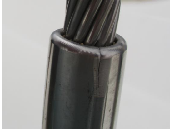
Ilustración 81. Fisura en el borde de un terminal prensado. Fuente: Propia
