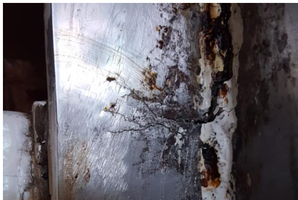
Ilustración 113. Grietas en un cadenote. Fuente: Propia
