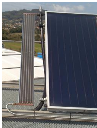
Il·lustració 9: Dissipador de calor connectat a un captador solar protegit
