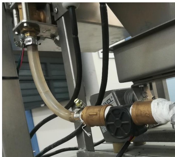
Ilustración 34: sensor de flujo del caudal de entrada a la ball mill
