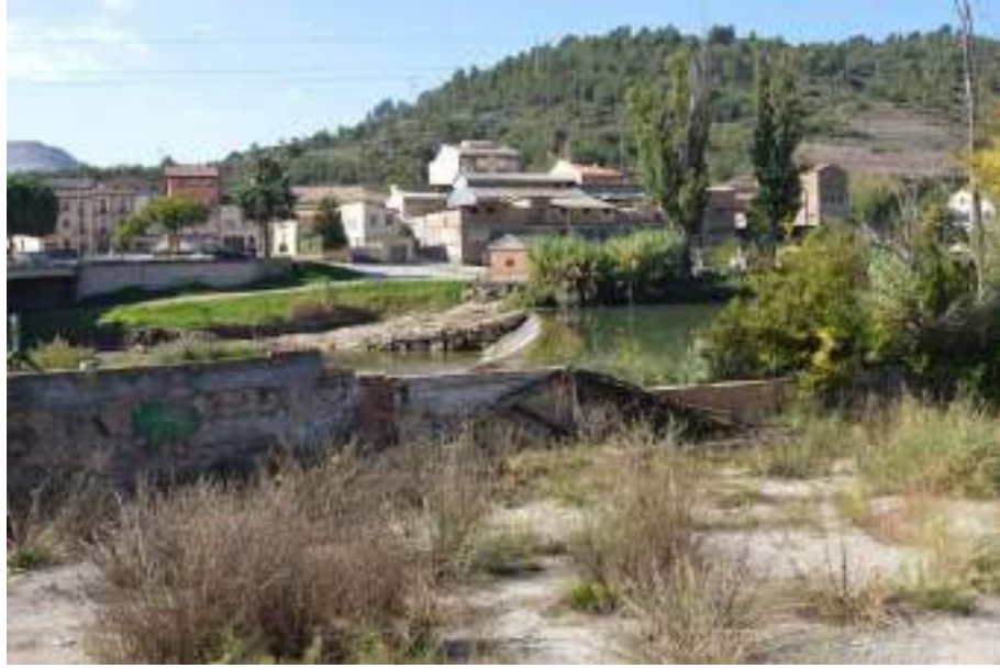
13 MUR DE CONTENCIÓ AL RIU. Estat deteriorat i diferents alçades del recrescut de maó i pedra.
