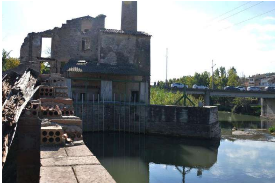
14 MUR DE CONTENCIÓ AL RIU. Perill de desprendiment del recrescut de maó
