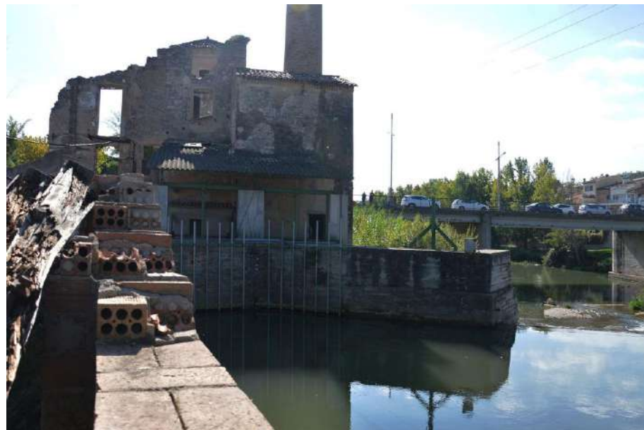
14 MUR DE CONTENCIÓ AL RIU. Perill de desprendiment del recrescut de maó
