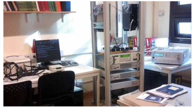
Fig. 6. Montaje experimental de la micro-red mostrada en la figura 5. A la izquierda se puede apreciar el conjunto de monitorización y control basado en PXI, y a la derecha el rack con los componentes de la micro-red de la figura anterior.
