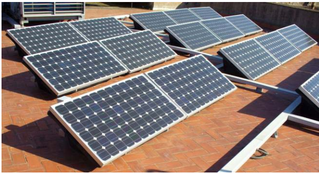
Fig. 3. Campo fotovoltaico de 3,1 kWp en la extinta EUETIB.
