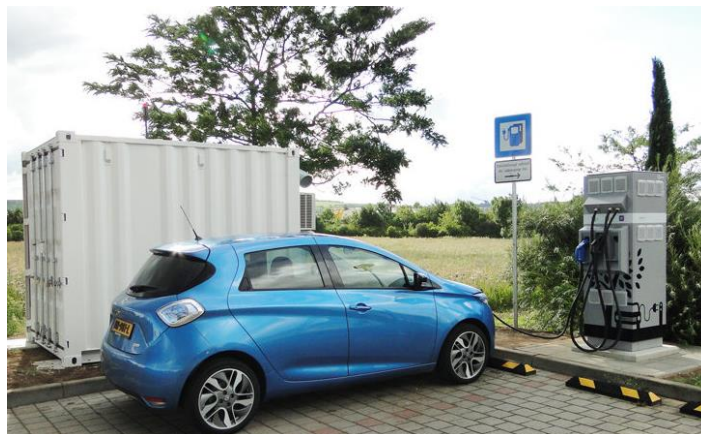
Figura 19. Punt de recàrrega en autopista E-Stor [19]
