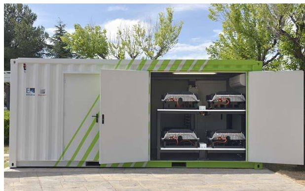
Figura 17. Instal·lació Sunbatt amb bateries de segona vida [17]
