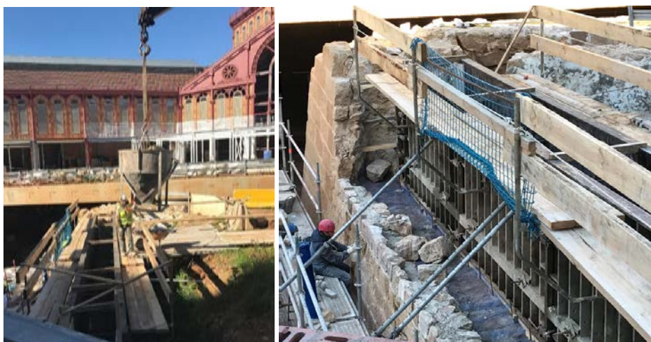
Figura 10. Proceso de hormigonado del Baluarte de la muralla medieval de Barcelona, bajo el mercado de Sant Antoni.
