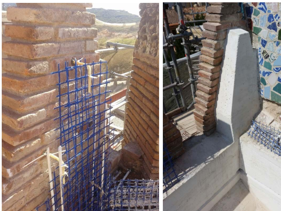
Figura 9. Detalles del refuerzo de las almenas y zuncho perimetral de la casa Puig i Cadafalch a Argentina. A la izquierda, conectores y armaduras de fibra de vidrio, a la derecha, elementos ya hormigonados. Foto de los autores.
