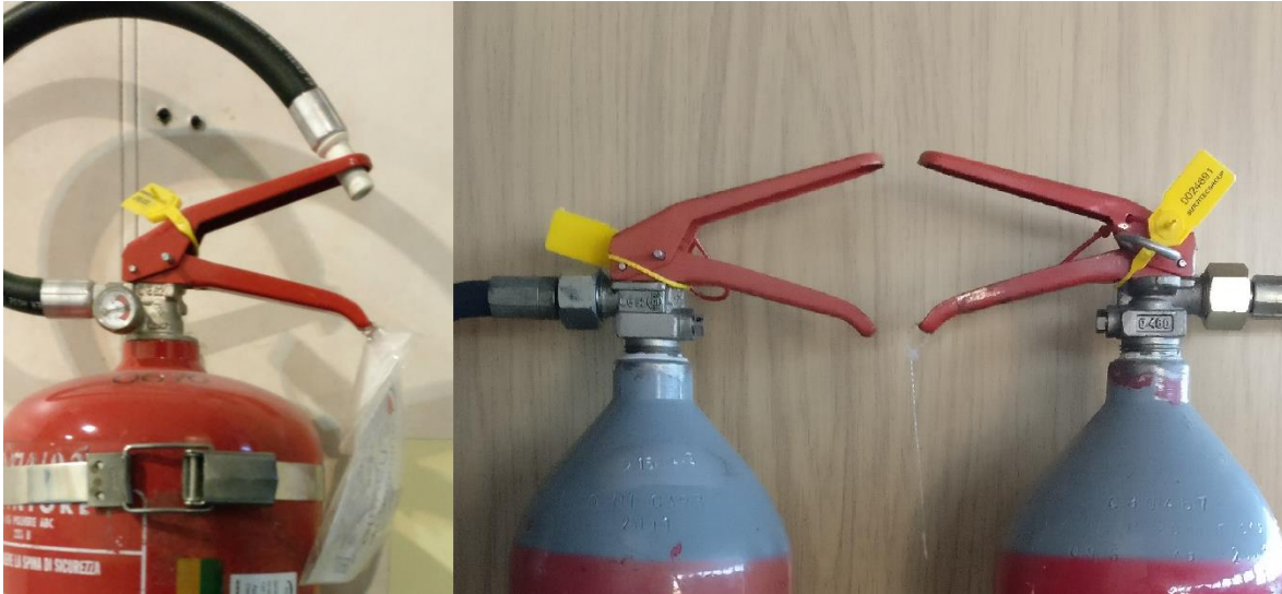
Ilustración 43. Bidas precintando las anillas de los extintores para saber si se han sacado. Fuente propia.
