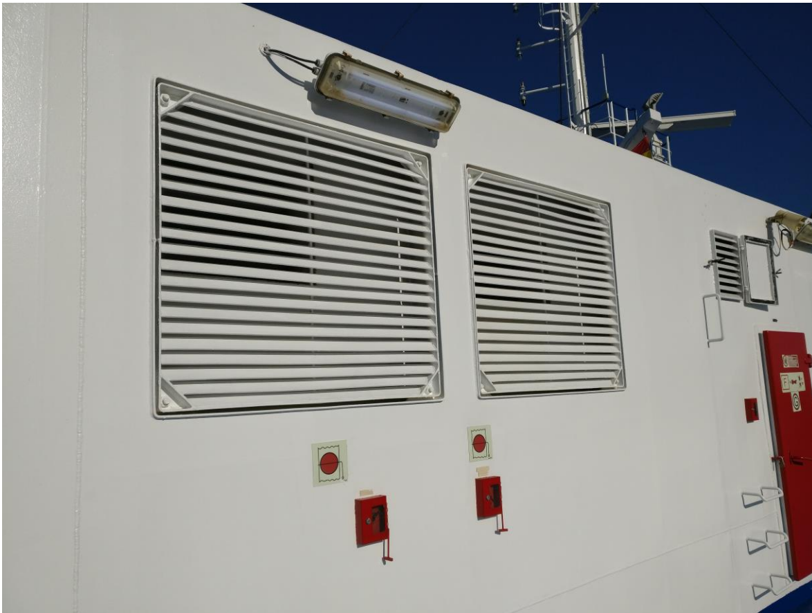
Ilustración 62. Vista de los dampers desde fuera, en las cajas rojas están los tiradores. Fuente propia.
