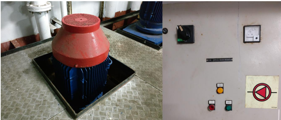
Ilustración 18. Bomba Contra Incendios de emergencia (izqda.); Panel de control de la Bomba (dcha.). Fuente propia.
