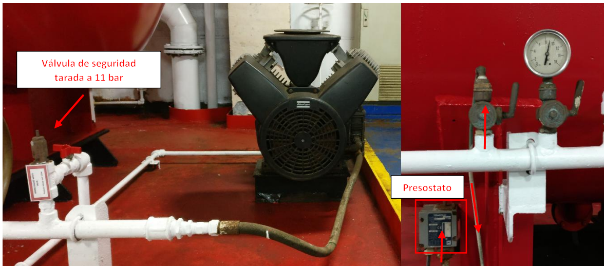
Ilustración 31. Compresor (izqda.) y Presostato que lo controla (drcha.). Fuente propia.
