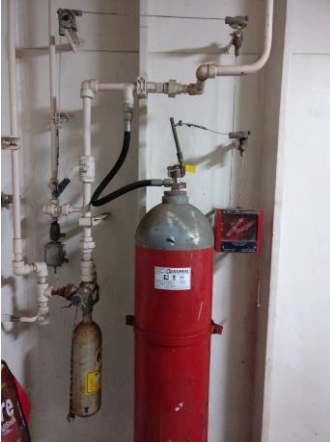
Ilustración 41. Cilindro del pañol de pinturas. Fuente propia.
