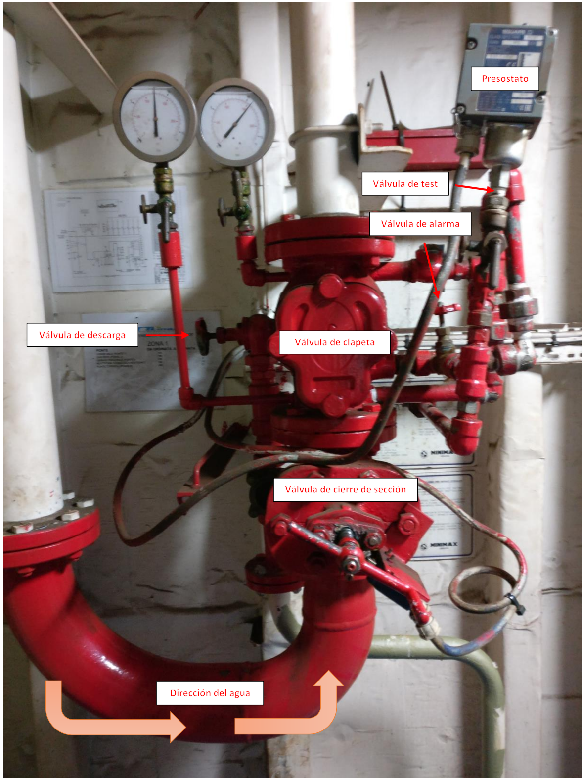
Ilustración 26. Válvulas de Sección Sprinkler n.1, la única que no está dentro de un armario. Fuente propia.
