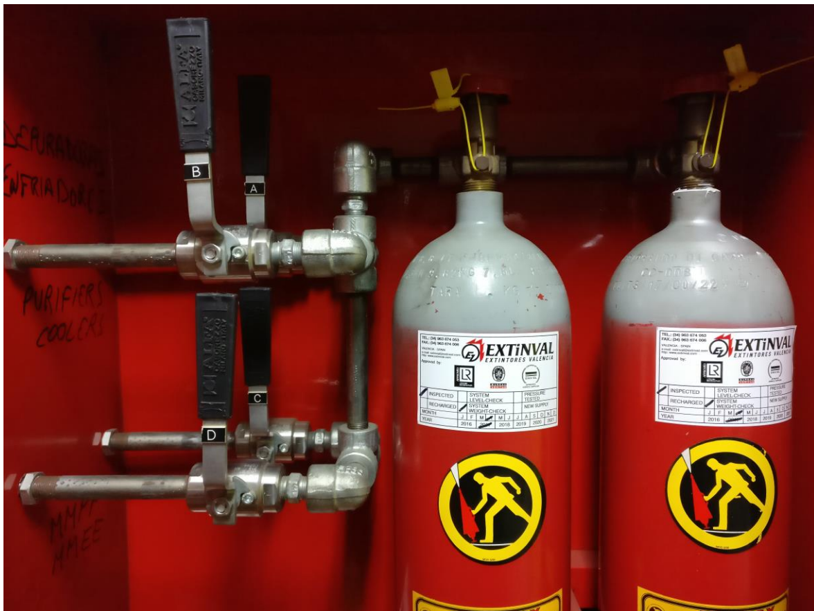
Ilustración 38. Cilindros de disparo del CO 2 en la estación de la chimenea. Fuente propia.
