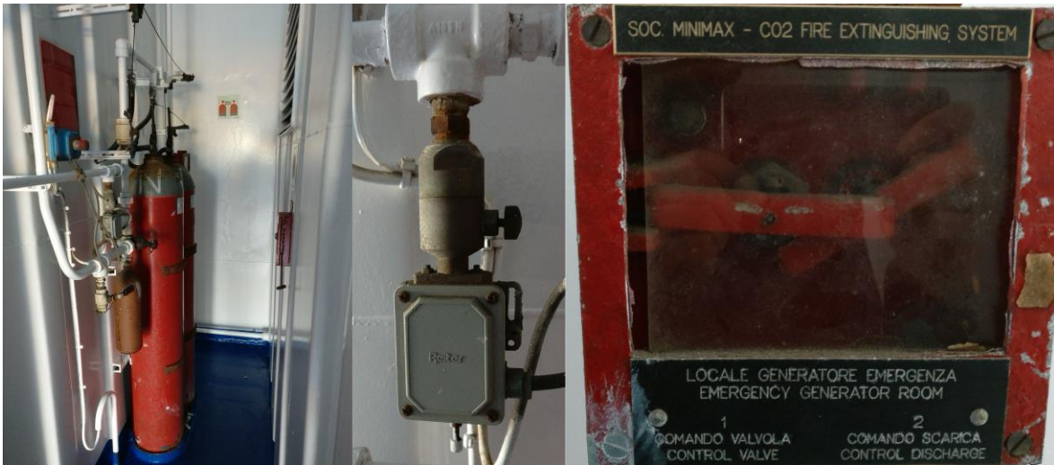
Ilustración 39. Estación completa (izqda.); presostato (centro); tiradores de control (drcha.). Fuente propia.
