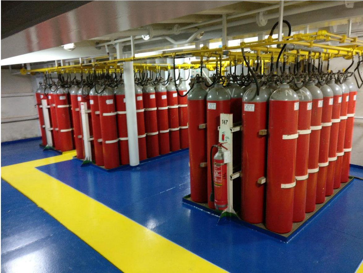
Ilustración 37. Local del CO 2 con las 105 botellas para la Sala de Máquinas. Fuente propia.
