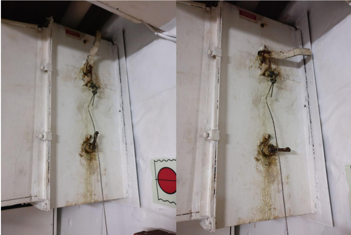
Ilustración 63. Fire Damper abierto (izqda.); Fire Damper cerrado (drcha.). Fuente propia.
