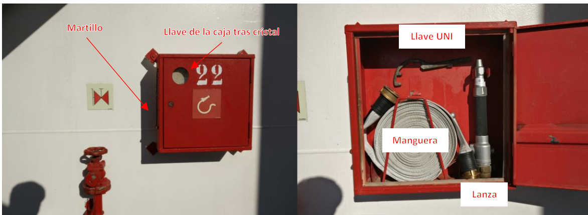
Ilustración 21. Caja de manguera junto a un hidrante. Fuente propia.
