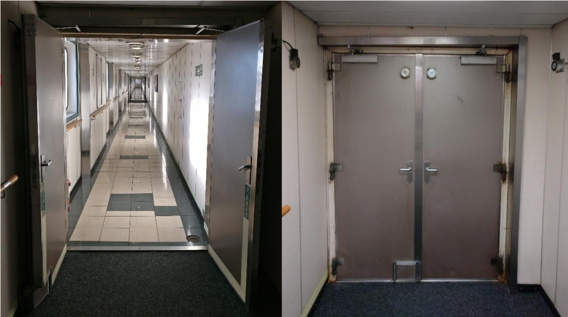
Ilustración 66. Puerta Abatible de Doble Hoja. Con la puerta cerrada se pueden ver los dos electroimanes que sirven para mantenerla abierta. Fuente propia.
