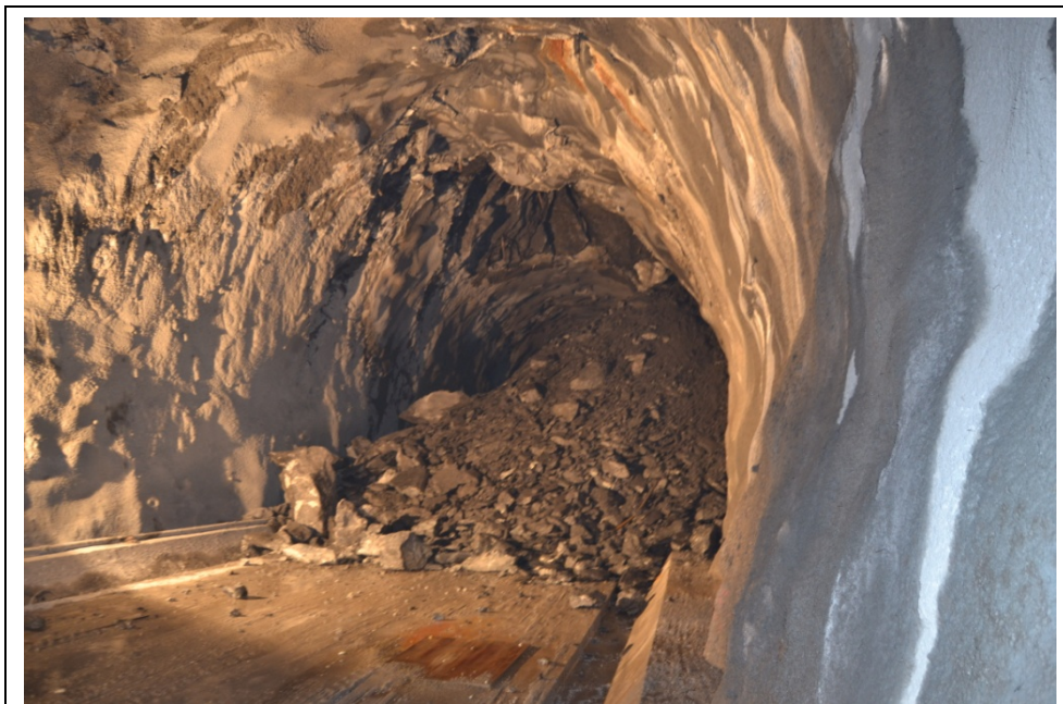
Figura 1: Imagen del colapso de una sección de un túnel con revestimiento provisional. ( Ledesma A. - Comunicación personal, 2017 )
