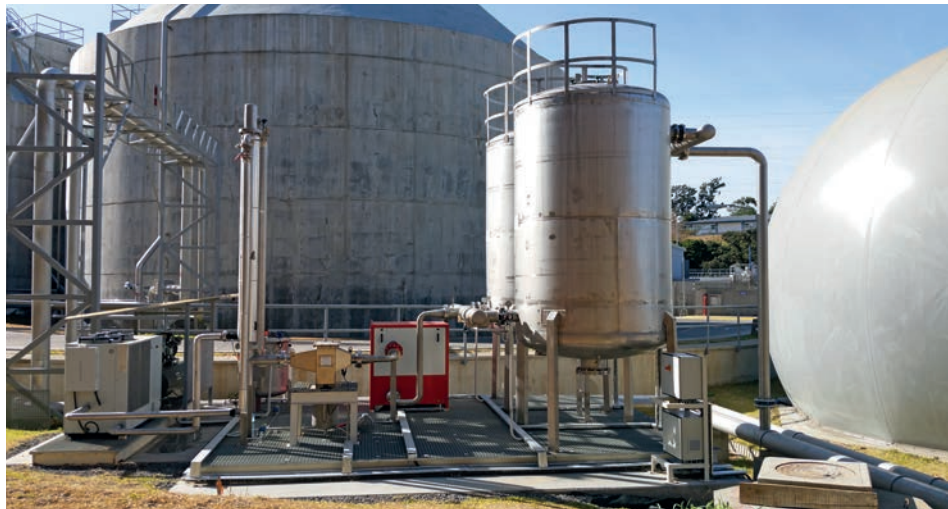
Figura 8.2. Planta de limpieza del biogás de la EDAR Los Tajos. San José de Costa Rica. Constructora Acciona aguas. Cortesía de Energy & Waste S.L. Elaboración propia
