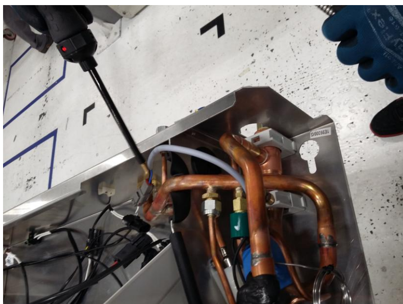
Fig. 25 operario intentado encontrar fugas en la máquina
