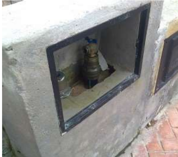
Figura 6.18. Arqueta de contadores. [Fuente: https://www.tecnologia-informatica.es/instalacion-de-agua-en-viviendas/ ]
