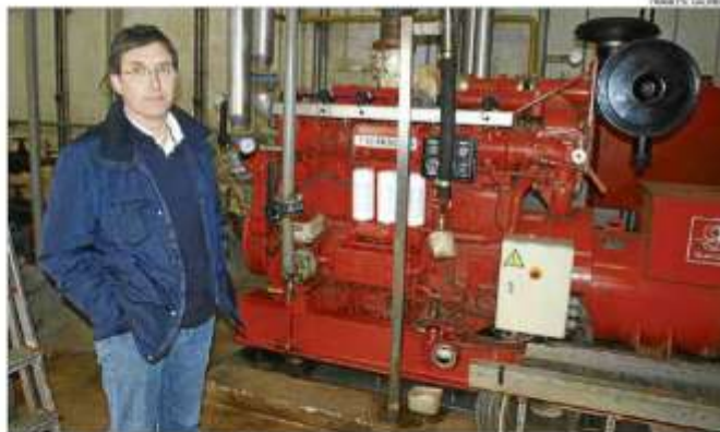
Ricard Tomàs, director d'Operacions d'Aigües de Manresa, amb el motor que funciona amb biogàs
