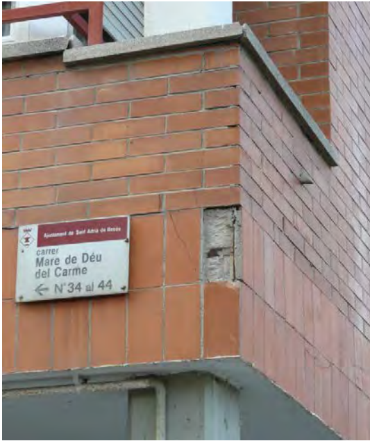
Figura 44.- Despreniment de l'aplatat de revestiment dels cantells de sostre. Sector Est i Oest, Sant Adrià del Besòs.
