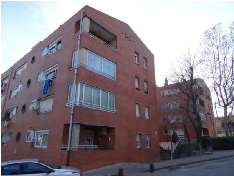
Figura 80. - Sobreposició de baixants de PVC en façana en la promoció de Rubí.
