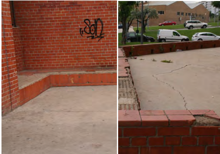
Figura 25.- Fissures en soleres zona interior de Baró de Viver
