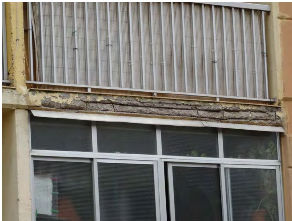
Figura 14. -Despreniment del recobriment de formigó degut a la oxidació de l'armadura. El Prat II.
