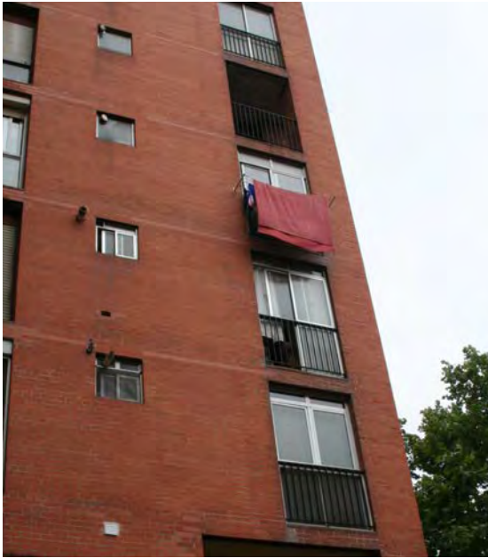
Figura 84.- Tancament de galeries i nova ubicació de ventilació de calderes. Baró de Viver I i II, Barcelona.
