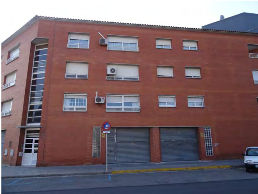
Figura 37. -Decoloració diferenciada en zones de recobriment de l'estructura mitjançant "pitxolís" en les façanes de la promoció Ripollet I.
