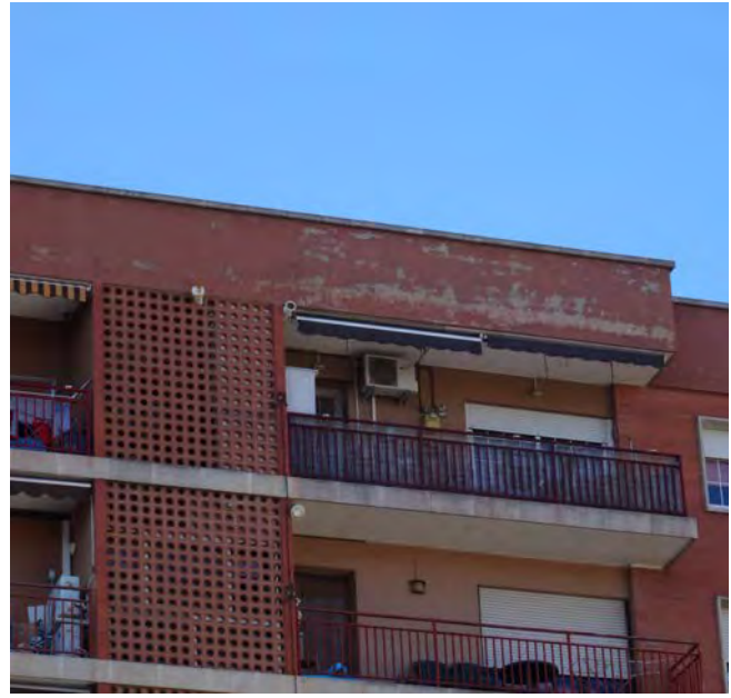
Figura 85. - Tancament de galeries i nova ubicació de ventilació de calderes. Olesa I, Olesa de Montserrat.
