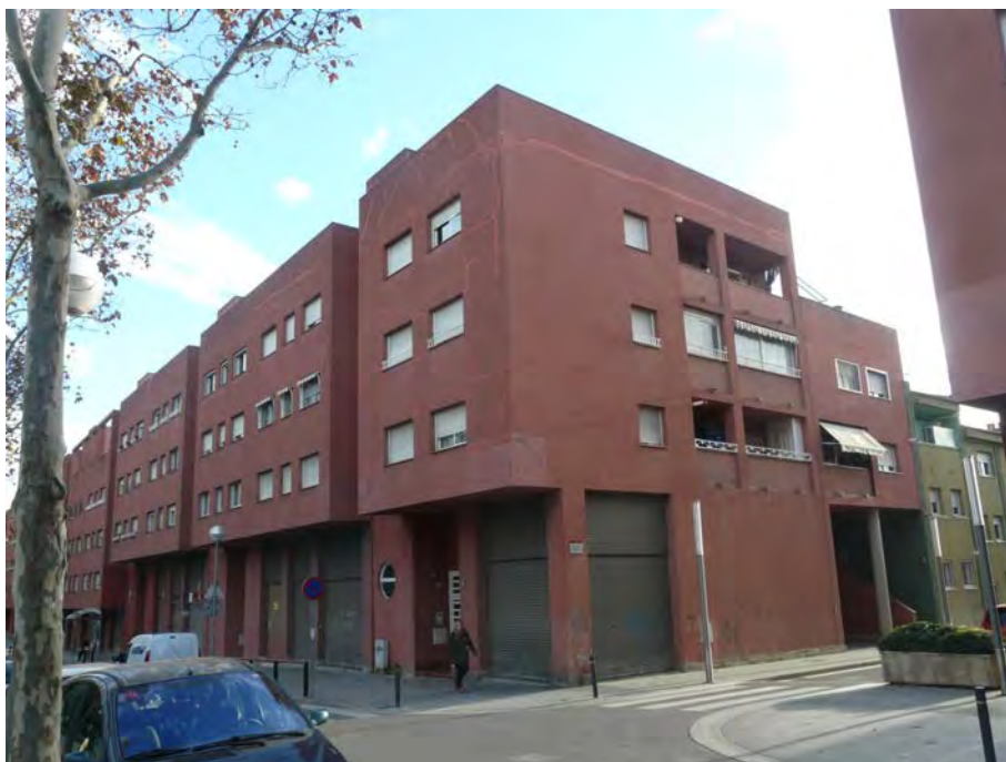
Figura 40.- Façana amb revestiment continu amb reparacions parcials a Mollet del Vallès, Gallecs 2.
