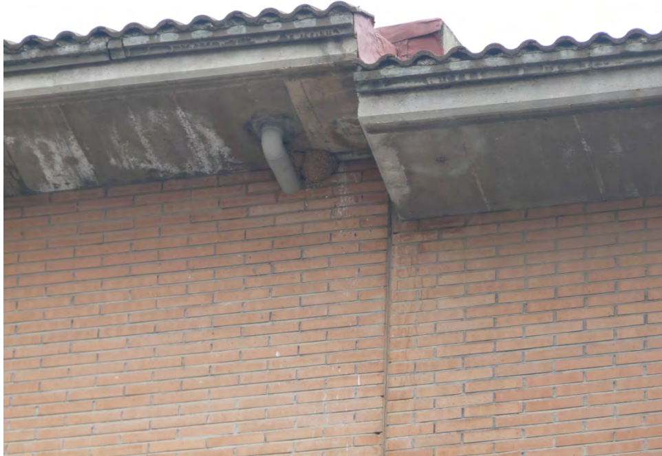
Figura 78. -Recollida d'aigües amb canaló integrat en coberta i baixant en PVC per l'interior de l'edifici. Tres Torres I, Granollers
