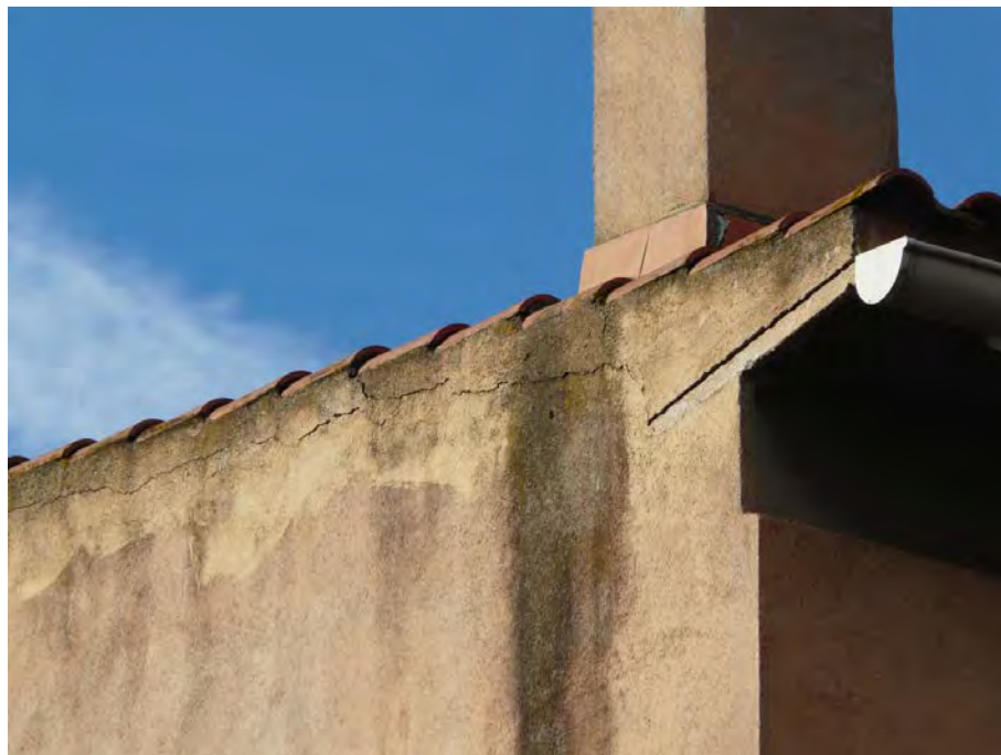
Figura 60.- Fissures i taques d'humitat en testers de coberta inclinada amb teula àrab, degudes a deficiències d'execució i moviments de dilatació tèrmica.
