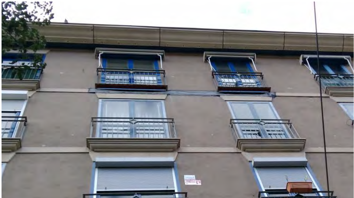
Figura 46.- Caiguda dels elements de pedra artificial que formaven els balcons i que estaven fixats mecànicament al cantell del sostre. Illa dels Àngels.
