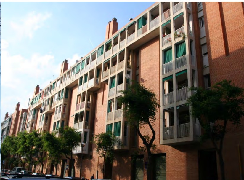
Figura 68.- Balcons amb barana perimetral, i abocat d'aigua directe. Can Clos, Barcelona.
