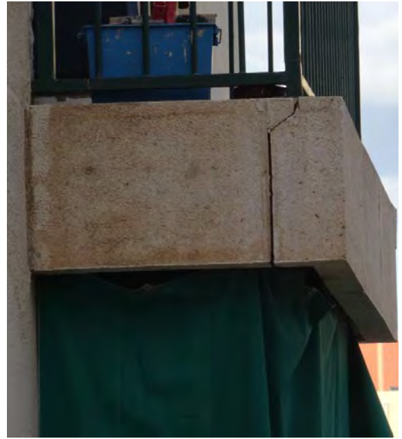
Figura 45.- Aplacat de cantells de sostre de balcó, reparats mitjançant fixació amb tac químic. Can Serra, L'Hospitalet de Llobregat.
