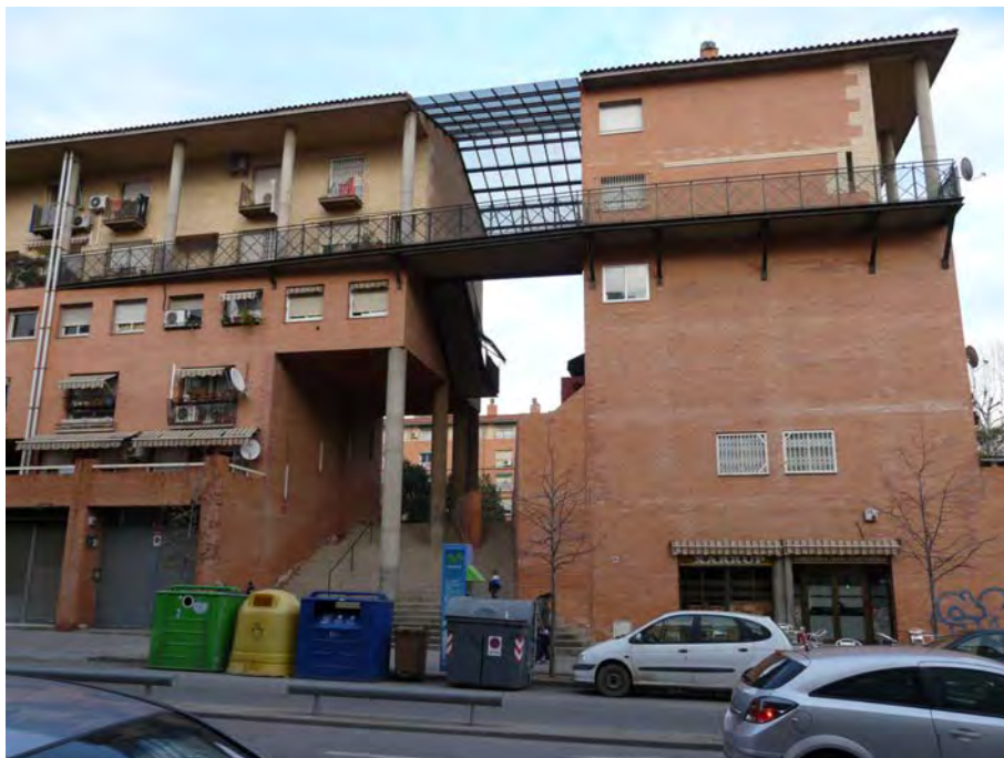
Figura 38.- Decoloració diferenciada i eflorescències puntuals en zones de recobriment de l'estructura mitjançant "pitxolís" en les façanes de la promoció Gallecs 1, Mollet del Vallès.
