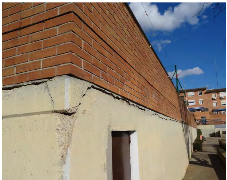
Figura 59.- Fissures en façana de pati interior de la promoció de Can Tussell, Terrassa, degudes a les dilatacions tèrmiques.
