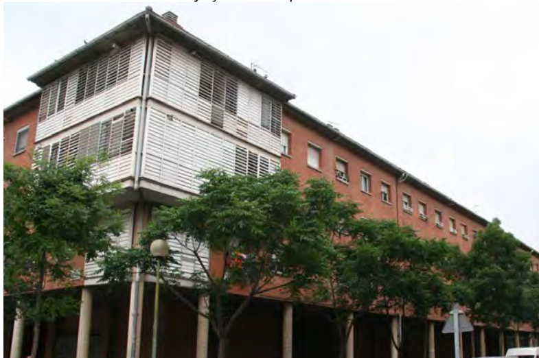
Figura 81.- Integració de baixants de PVC vistos en façana de la promoció Baró de Viver I. Barcelona.
