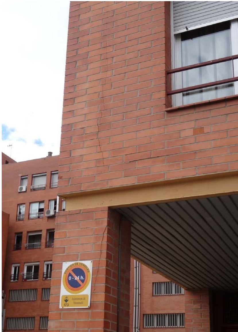
Figura 41.- Fissures verticals en façana a la promoció Pla Pedregar, degudes probablement a les deformacions del sostre de planta baixa.
