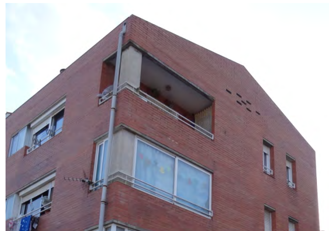
Figura 50. - Coberta de la promoció de Rubí, sense ràfec, amb canaló perimetral i baixants per exterior de l'edifici.
