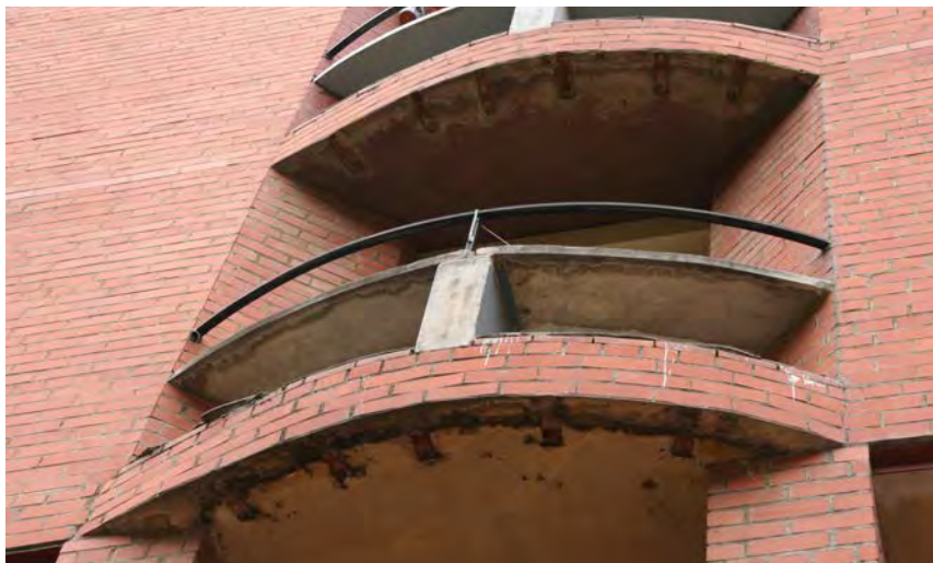
Figura 73.- Manca de voladís en rajola de paviment i en cantell de sostre, permetent que l'aigua provoqui l'oxidació les peces de suport dels "pitxolís". Baró de Viver I, Barcelona.
