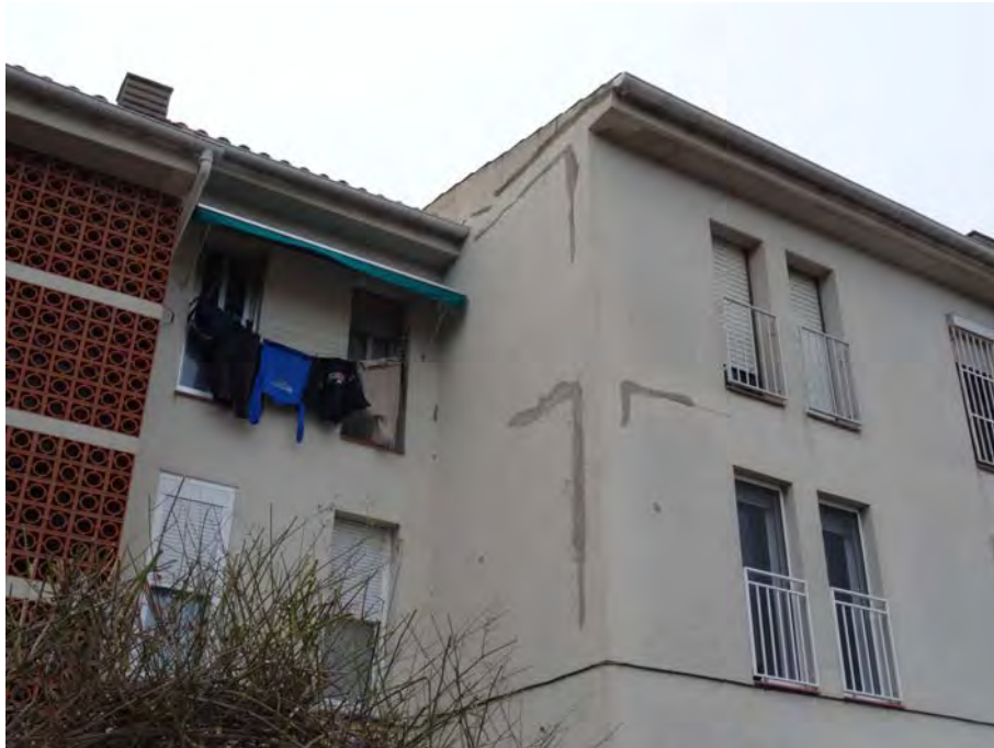
Figura 39.- Façana de la promoció de Santa Coloma, amb l'arrebossat original sense junt de dilatació. I reparacions parcials en les fissures aparegudes en les unions entre parament i estructura.
