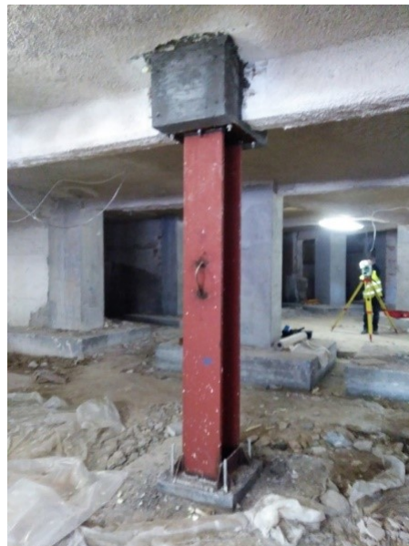
Figura 5-74: Cubo de hormigón en la parte superior del pilar
