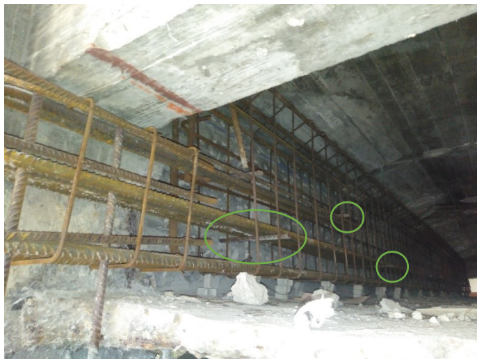
Figura 5-15: En los círculos verdes pueden verse las perforaciones que atraviesan la jácena
