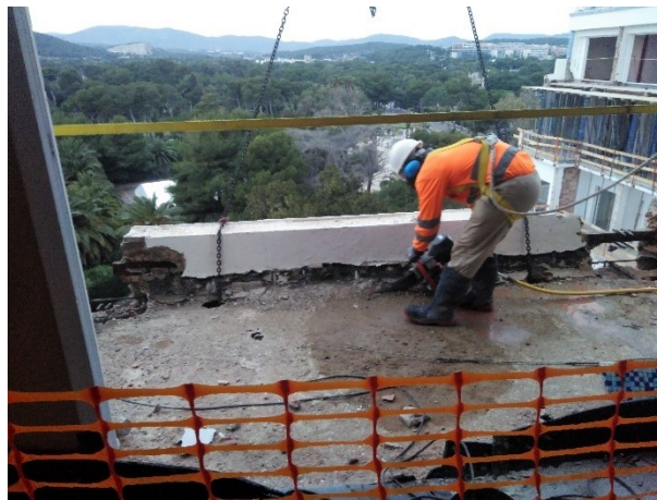
Figura 5-41: Sujeción de lo que se quiere derruir por medio de la eslinga
