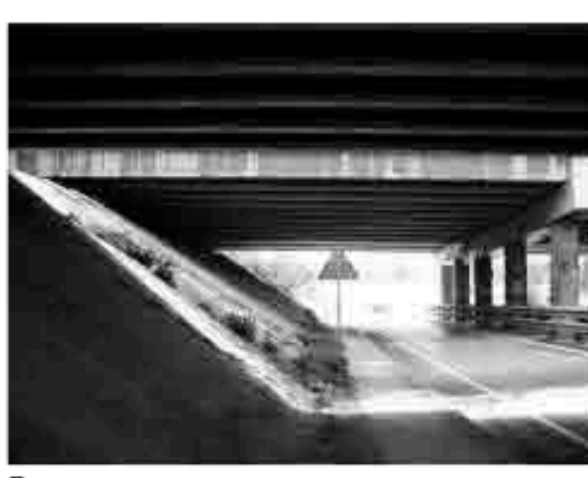
Passatge Pas per sota l'Autopista, sense accés per a vianants
