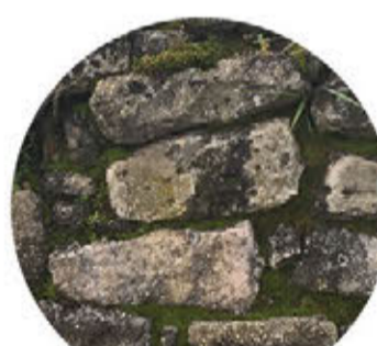
Presència d'eflorescències i fongs en la superfície de les pedres.
