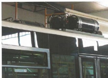
Figura 44. Localización depósito parte superior en autobuses.
