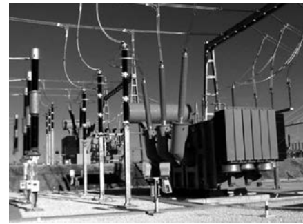
Figura 14.5. Transformador trifàsic operant en una subestació transformadora d'energia elèctrica
