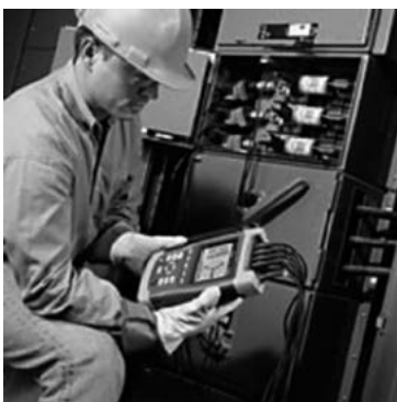
Figura 5.6. Presa de mesures sobre una escomesa.
