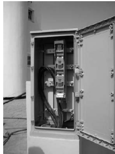
Figura 5.5. Quadre d'una escomesa provisional.
