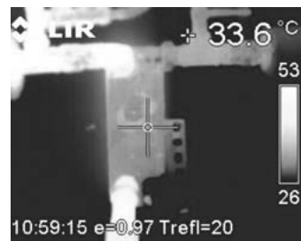
Figura 4.3. Termografia de funcionament d'un bescanviador.
