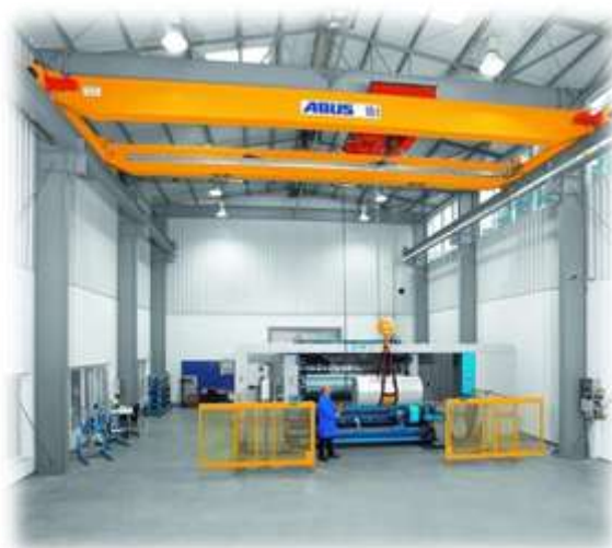
Figura 14: Puente grúa Fuente: Logismarket.es
