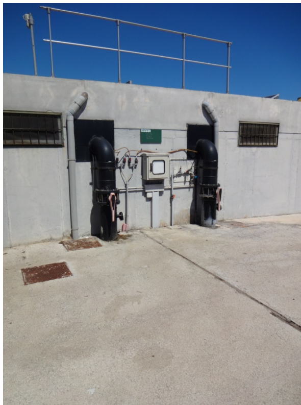
Figura 4.4.2.12. Entrada al dipòsit de distribució amb els detectors de cabal
