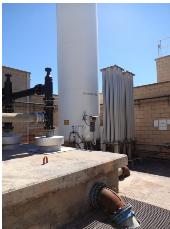
Figura 4.4.2.3. Foto del dipòsit de baixa i del dipòsit de CO 2
