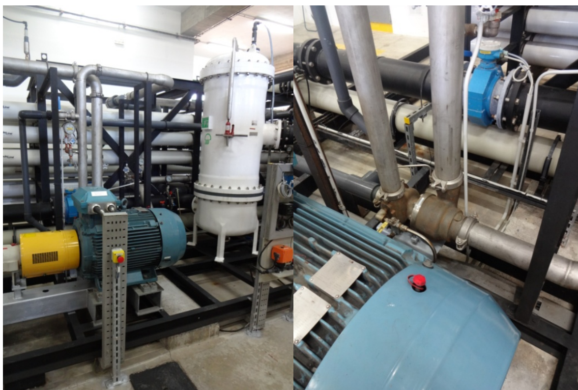
Figura 4.4.2.9. Esquerra: Bomba d'alta pressió i microfiltració Dreta: Turbocharger.
