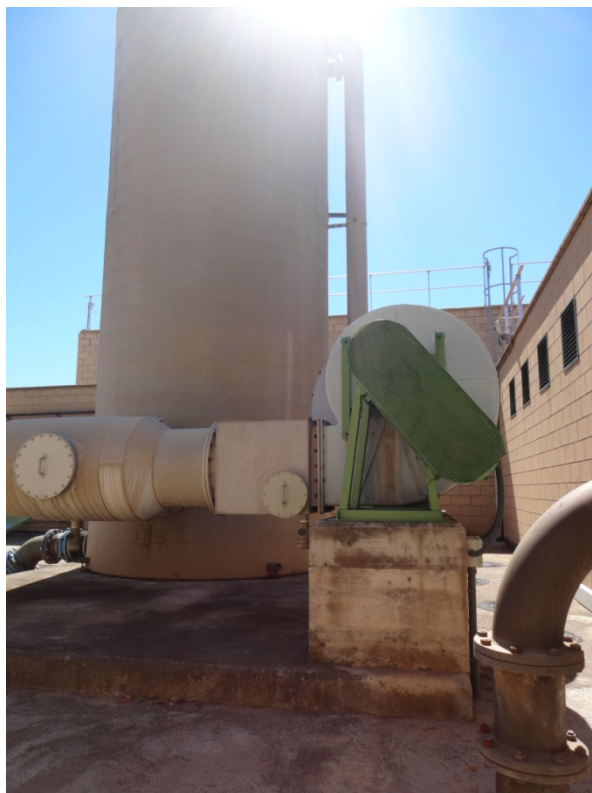
Figura 4.4.2.2. Foto de la torre d'Stripping i d'un dels ventiladors de la torre.
