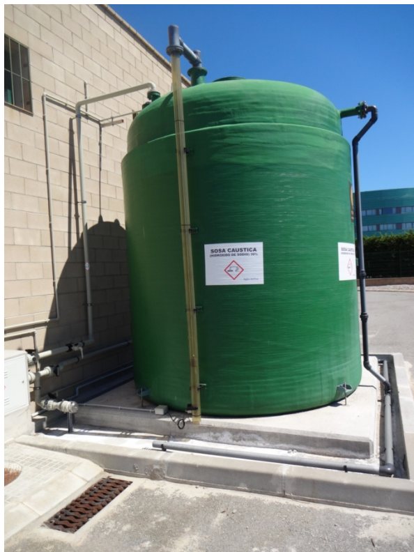
Figura 4.4.2.11. Dipòsit de sosa càustica
