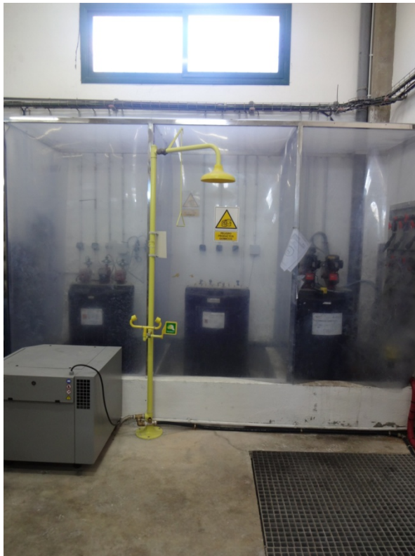
Figura 4.4.2.6. Foto dels dipòsits de reactius
