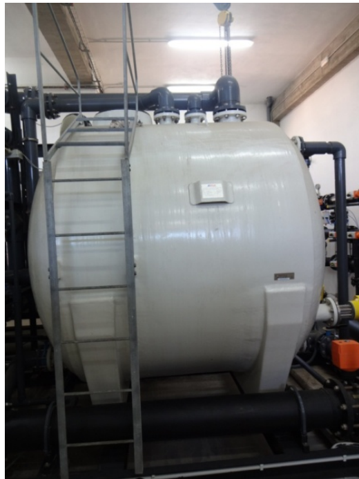
Figura 4.4.2.10. Dipòsit de flushing
