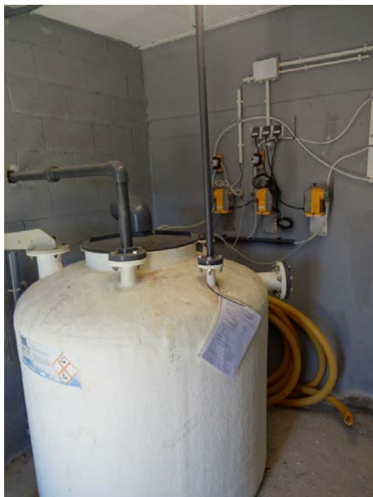
Figura 4.4.2.13. Dipòsit d'hipoclorit sòdic
