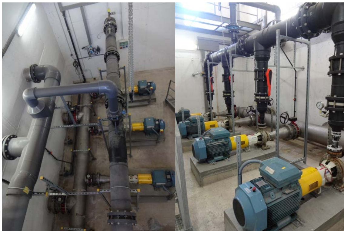
Figura 4.4.2.14. Esquerra: Col·lector del dipòsit Dreta: Bombes d'impulsió a xarxa
