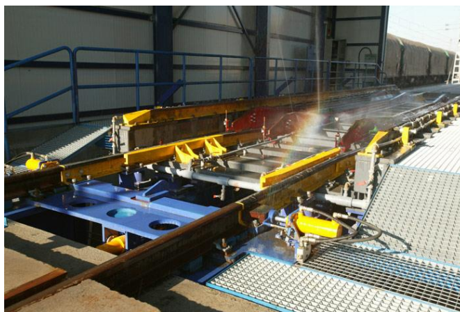
Figura 12-6. Detall del canviador d'ample a la instal·lació tècnica de Santa Catalina (Madrid)
