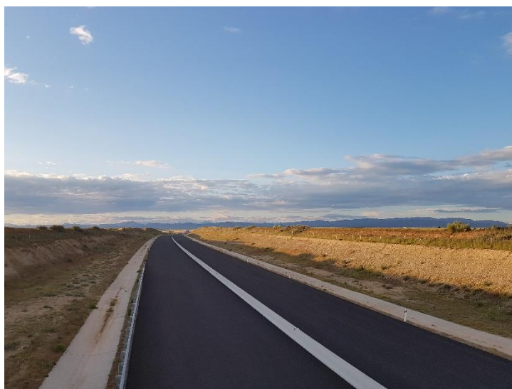
Figura 8-4. Plataforma de l'autovia A-14 al seu pas per Alguaire asfaltada amb una capa de base. Al fons de la imatge, la Serra del Montsec
