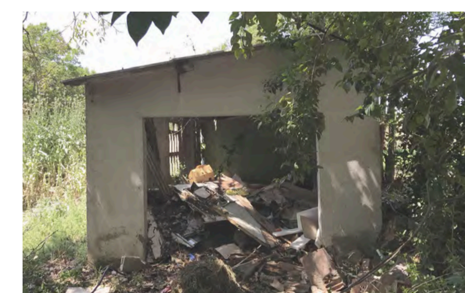
Edificació en mal estat
