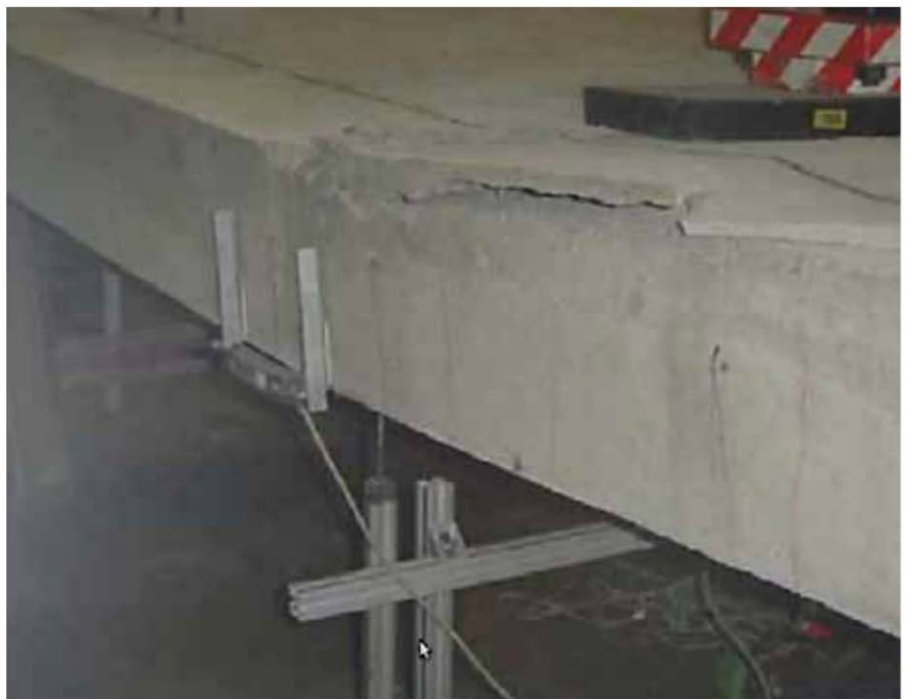
Figura 9.- Estado de la fibra OBR tras el ensayo. Vista del estado de la losa tras la rotura
