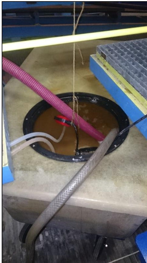
Figura 16. Dipòsit auxiliar amb la bomba en el seu interior.
