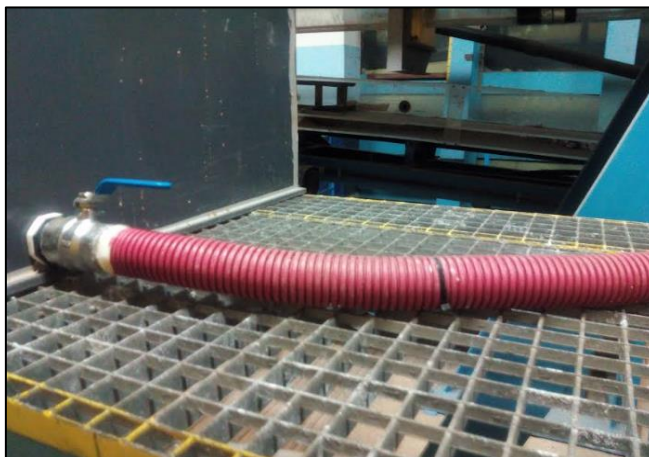
Figura 18. Canonada de retorn en la sortida del sobreexidor 2.
