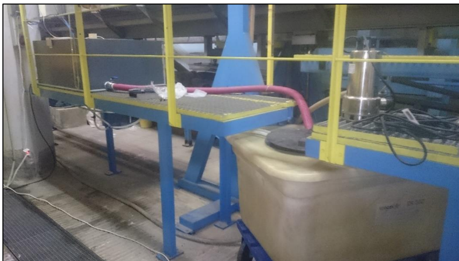
Figura 30. Vista del dipòsit 2 (esquerra de la imatge) i del dipòsit auxiliar (dreta de la imatge) connectats amb la canonada de retorn.
