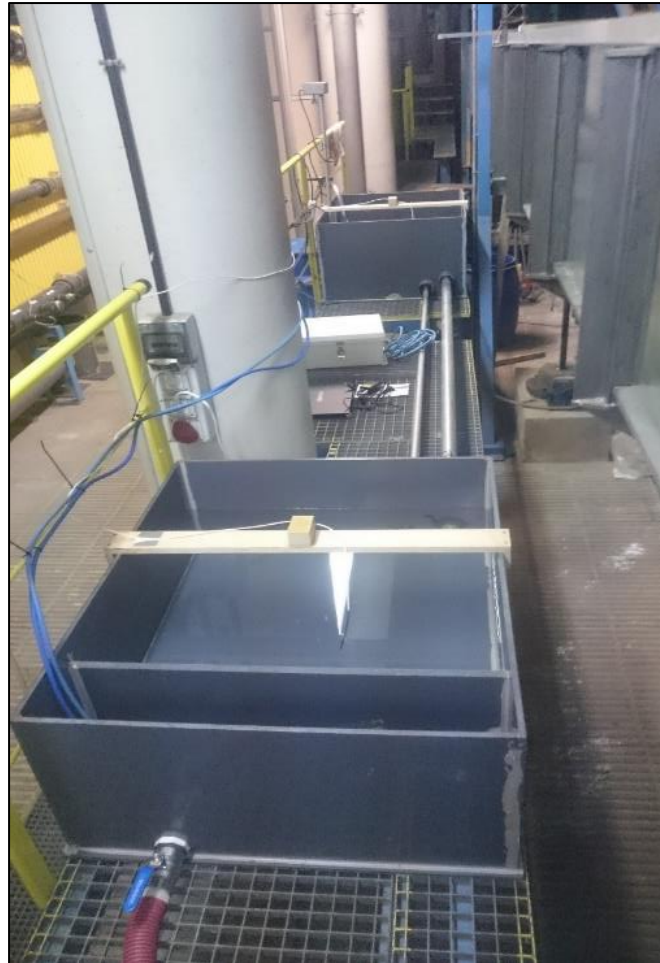
Figura 17. Vista del circuit hidràulic des del dipòsit 2.
