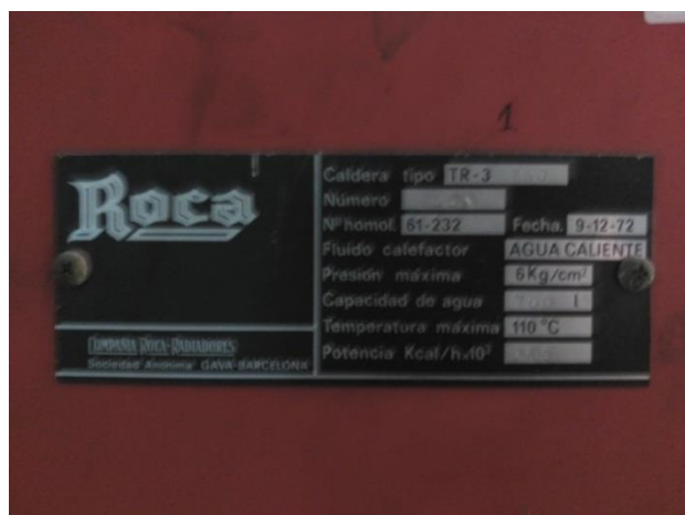
Figura 8 – Detalle de la placa de una de las calderas.
