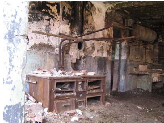
FOTOGRAFIA 2. Un aspecte de la pèrdua de patrimoni
