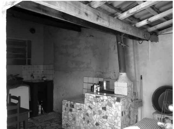
Fig. 6 - Área de serviço integrada à varanda com forno a lenha na CNH09
