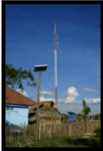
Figura 7.- Paneles solares que alimentan un PS.
