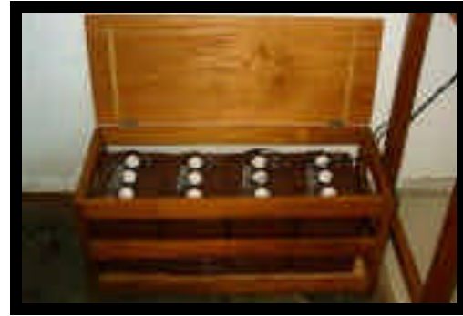
Figura 8.- Baterías que alimentan los equipos EHAS.
