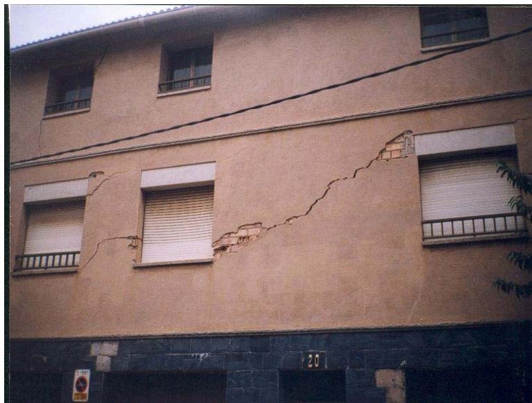
Aspecte de les conseqüències de l'esfondrament, sobre una de les vivendes. Ara ja esfondrada, des de fa uns 4 anys
