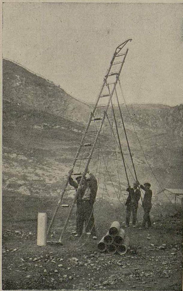
Poste de hormigón armado "Sistema Palomar", patentado. Elevación de la escala-guía.
