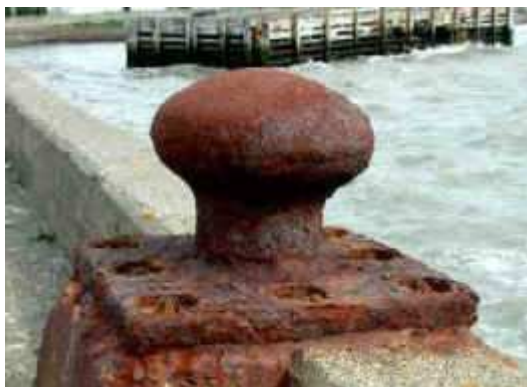
Figura B.14. Corrosión uniforme en un ambiente marino.
