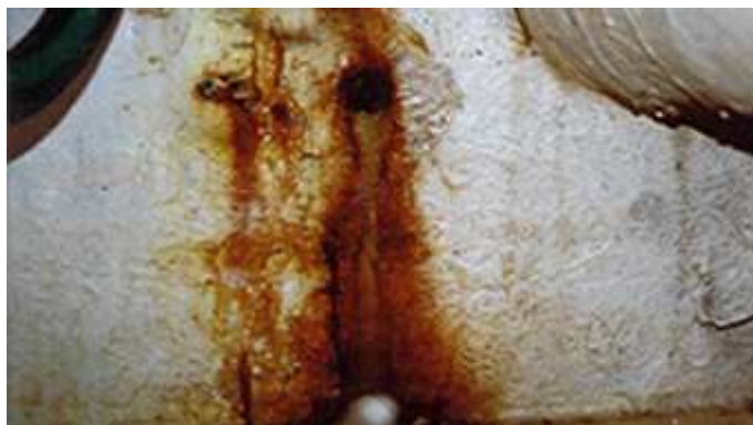
Figura B.17. Corrosión en resquicio de una zona de difícil acceso.
