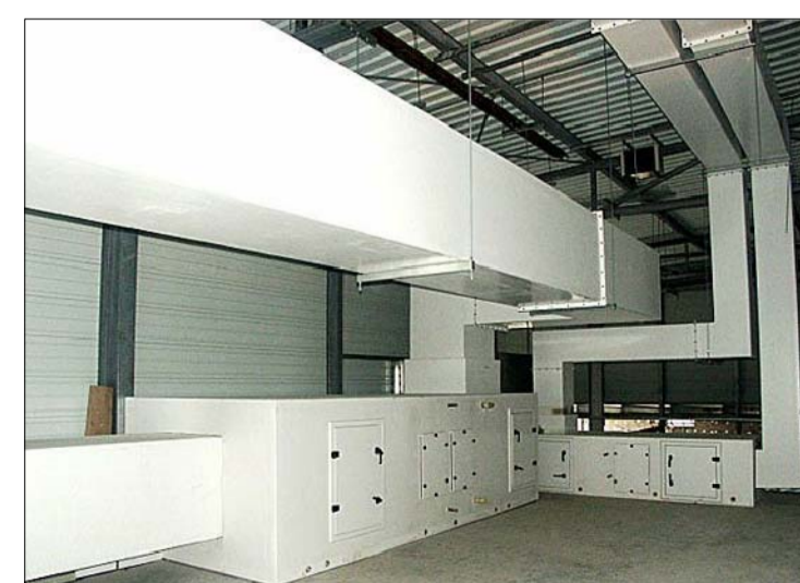
Exemple de conductes de climatització amb protecció anti-incendis.
