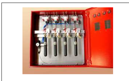
Quadre pneumàtic de control (2)
