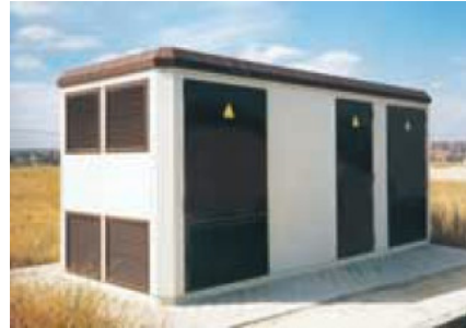
Fig. 7. Centro de transformación PFU-4
