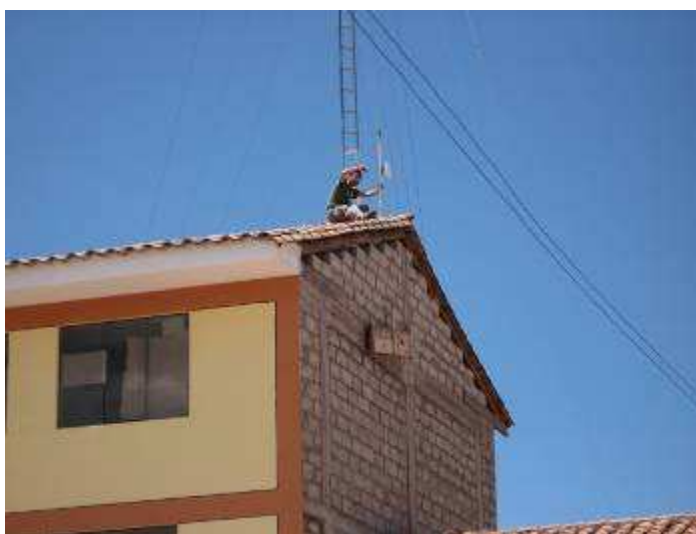
Figura 4.2: Instalación de antena en la municipalidad de Sangarará
