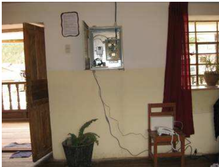
Figura 4.4: Equipos instalados en el Instituto Pedagógico de Pomacanchi
