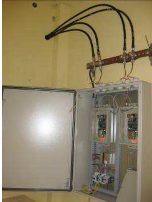
Figura 4.3: Equipos instalados en el repetidor Josjojahuarina 1
