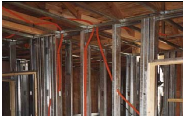
Figura 1.8. Instal·lació elèctrica als mòduls de paret [9]
