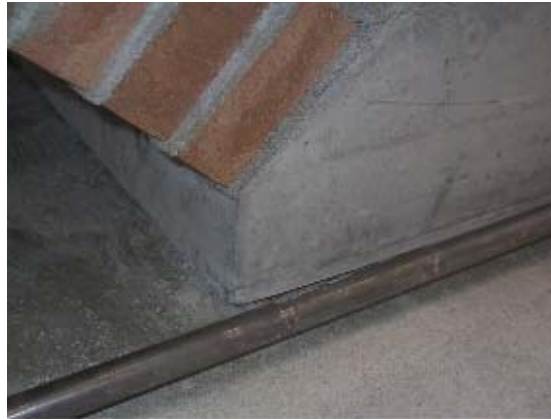
Figura 2-36. Levantamiento de la losa de hormigón en el lado no cargado. Imagen tomada de [5].
