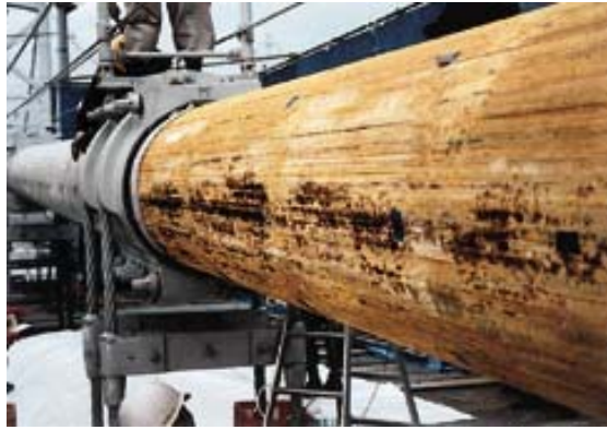
Foto 7: Corrosió d'un dels cables principals del pont suspès de Innoshima, Japó. (Font: [9]).
