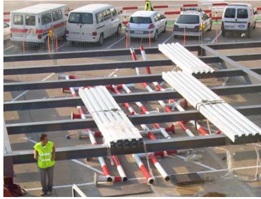
Figura 2.8. Construcción de forjado mixto de chapa colaborante en el aeropuerto de Girona.
