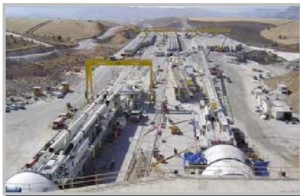
Fotografía 2.- Boca sur de los túneles con las tuneladoras en su fase inicial.
