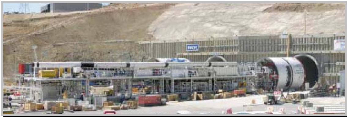
Fotografía 3.- Vista detallada de las tuneladoras en su fase inicial y de la boca sur.
