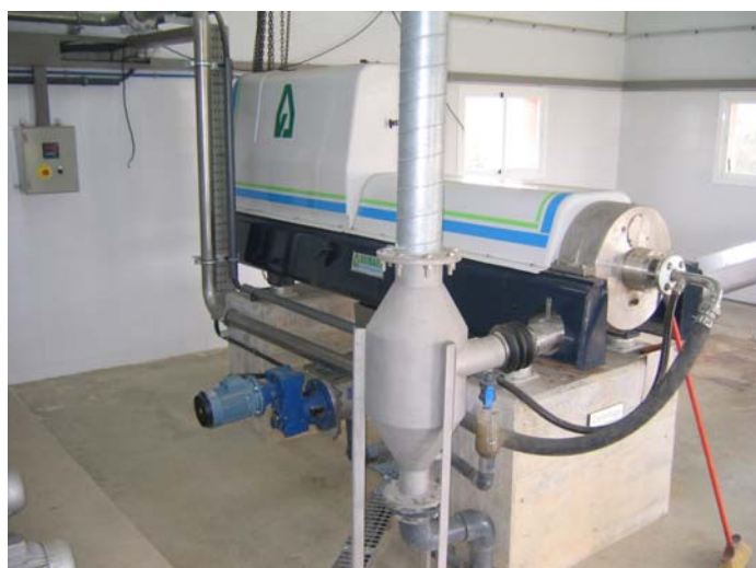
Figura.3.2.2.4.1 Deshidratación de fangos.
