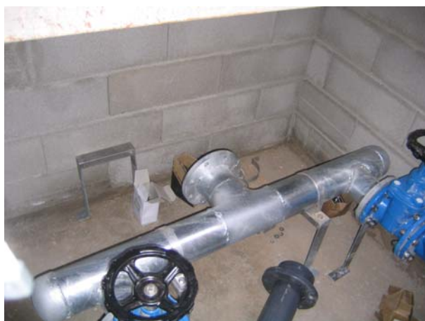
Figura.4.2.3.1 Colector bombeo inicial.
