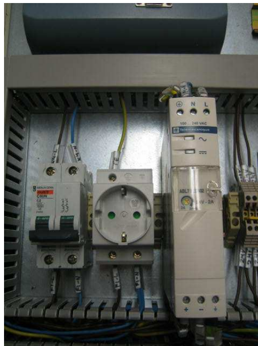
Figura 8.2. Fuente de alimentación junto con el magnetotérmico
